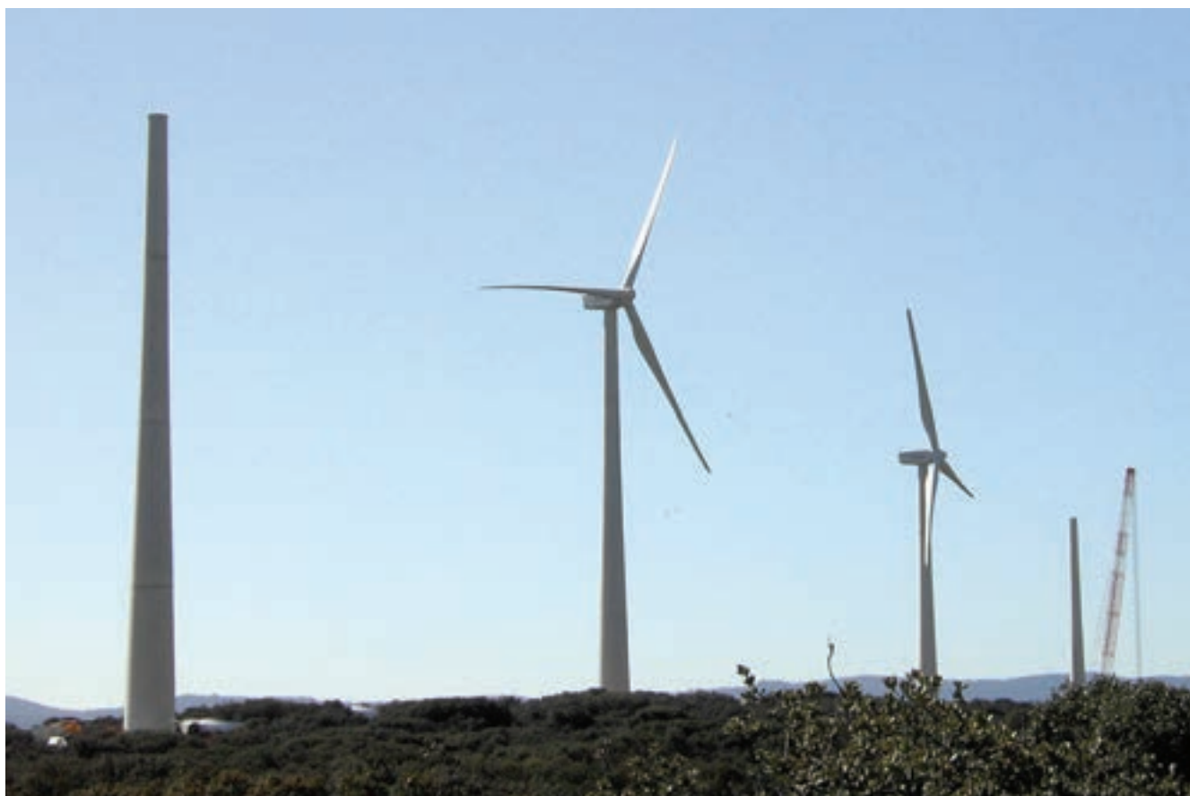
Aerogeneradores modelo Alejandría, prefabricados de hormigón. Esteyco, Inneo.
