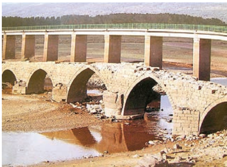
Puente de piedra fuera de servicio: uno de los caminos más rápidos a seguir si se desea llevar una obra al camino de la ruina total.
