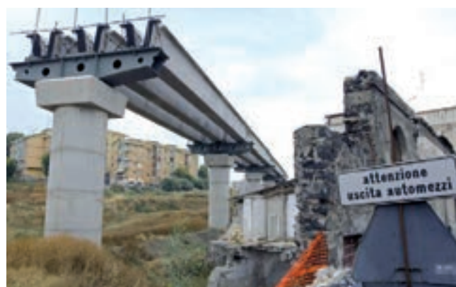
9 - Proyecto modificado... y abandonado. Sin comentarios. Así, desde luego, es imposible crear un paisaje construido de calidad.
