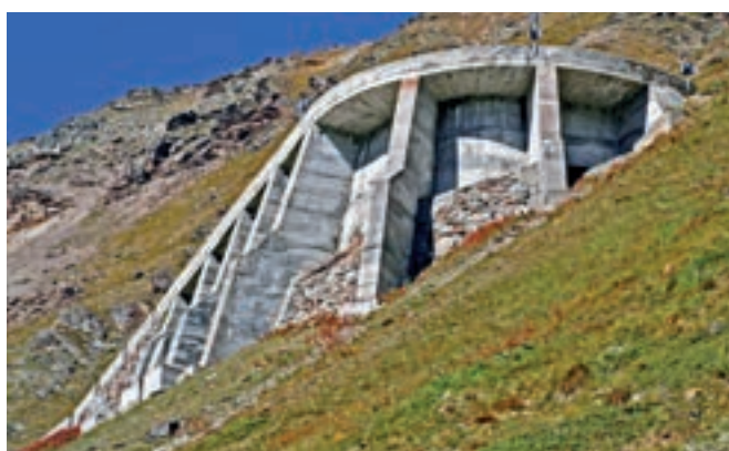
8 - Muro de contención eficiente para una carretera de montaña, pero no precisamente bien contextualizado.
