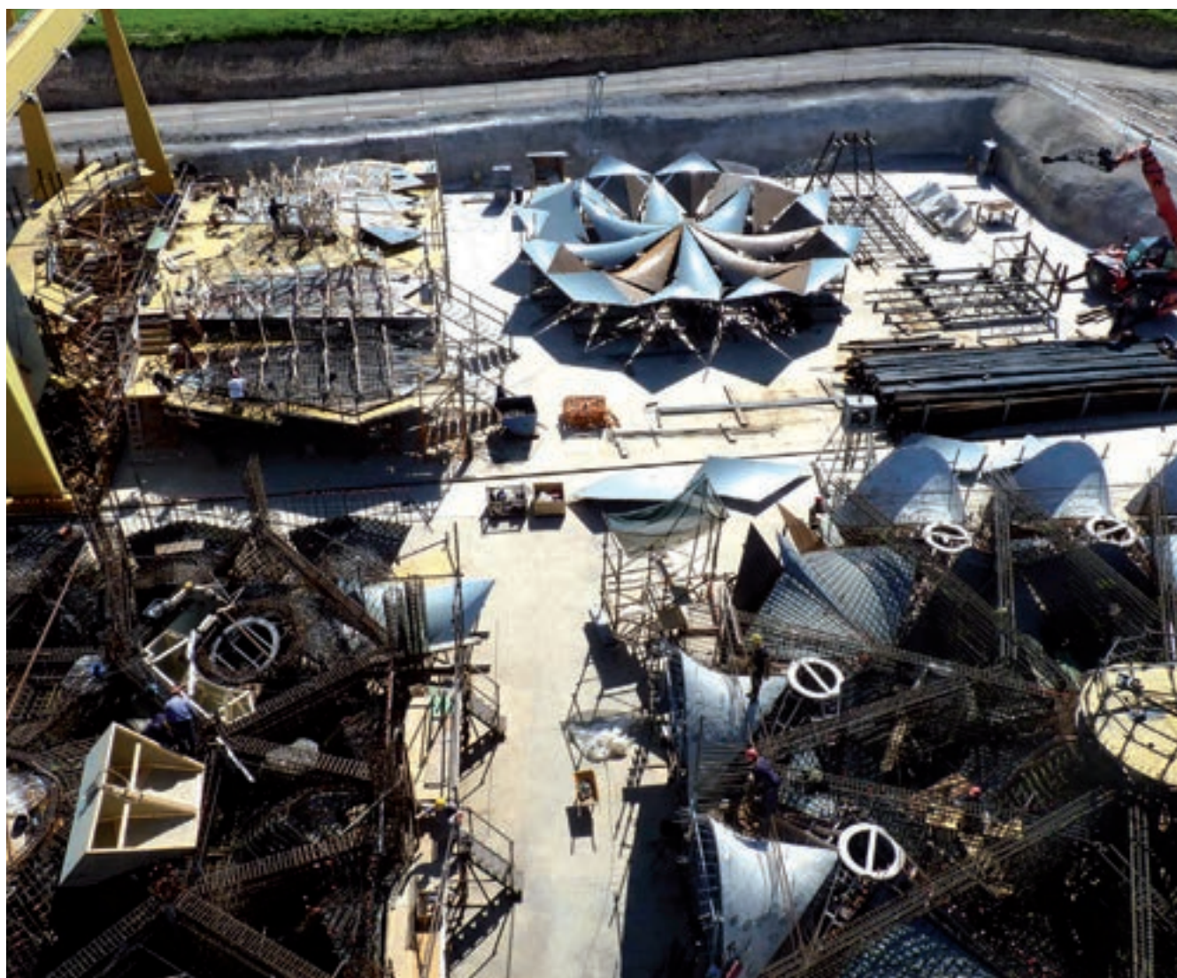
Imagen 24. Ejecución de premontajes de encofrados y armados de los pisos de la Sacristía.
