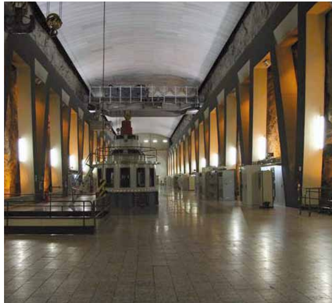
Figura 25. Interior de la central hidroeléctrica de Aldeadávila I.
